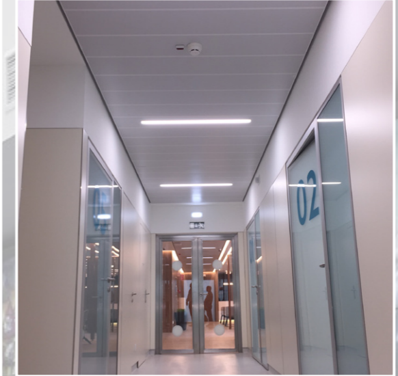
Sistemas de techo para pasillos con bandejas metálicas de 300mm
