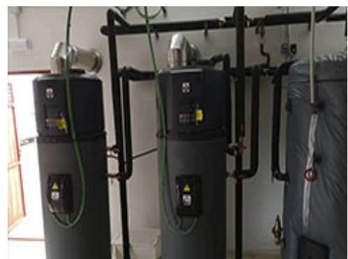
Instalación combinada de aerotermia y placas solares para producción de ACS
