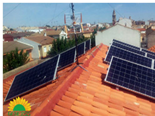
Instalación de autoconsumo de energía fotovoltaica en una vivienda unifamiliar
