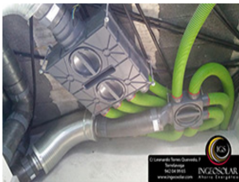
Instalación de ventilación con recuperación de calor en una vivienda unifamiliar
