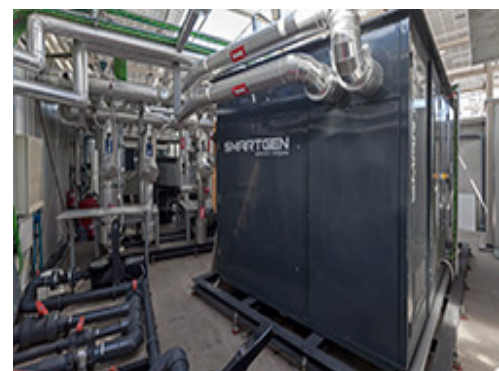
Instalación de dos calderas de condensación con microgeneración
