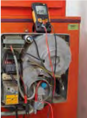
Medición de la corriente de ionización con el testo 760.
