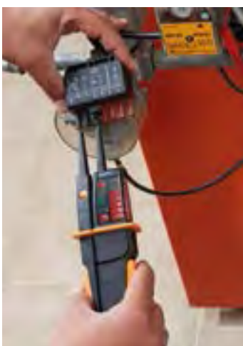
Comprobación de tensión en el enchufe de una instalación de calefacción con el testo 750.
