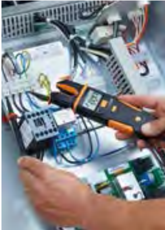
Medición de tensión en un compresor con el testo 755.
