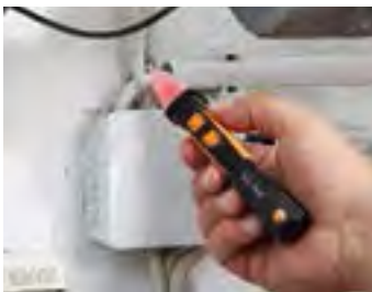
Prueba de tensión sin contacto en una caja de distribución hacia una instalación de calefacción con el testo 745.
