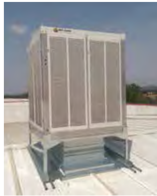
AD- 40-V en nave industrial
