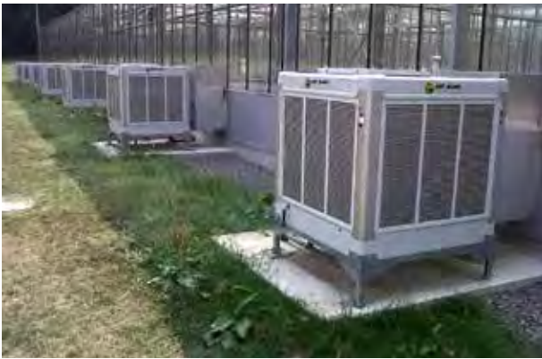
Instalación AD-15-H en un invernadero
