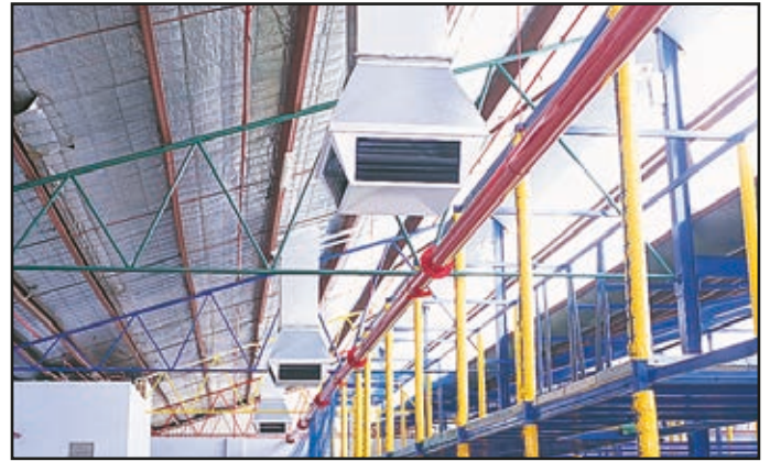
Los evaporativos en locales industriales mejoran el confort aumentando la productividad con un coste muy bajo
