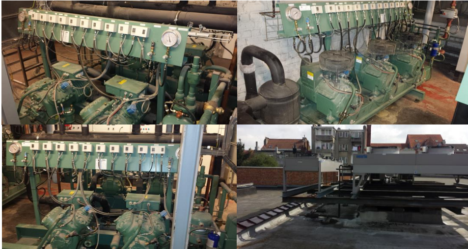
Figura 7. Centrales de frío supermercado belga
