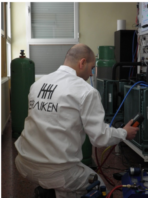
6. Ilustración. TOMA DE DATOS DE LA INSTALACIÓN
