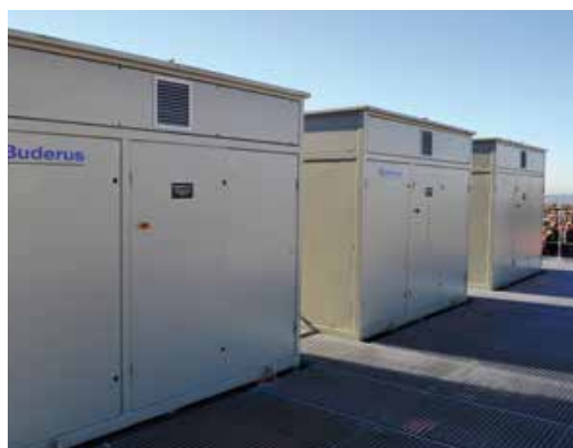
Instalación Logablok plus MODUL GB402 en Hotel Meliá Castilla (Madrid)
